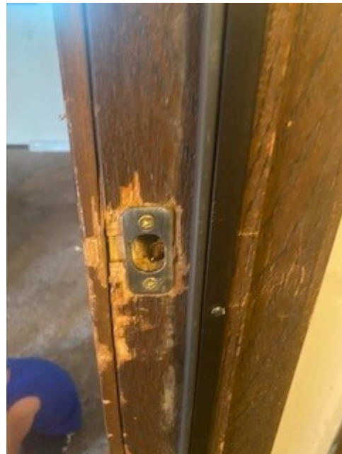
Broken door jam
